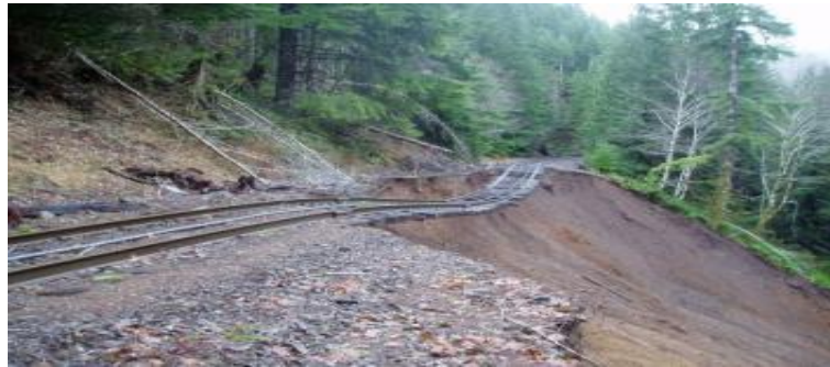
Рисунок 1. Оползни, повлиявшие на транспортные пути
